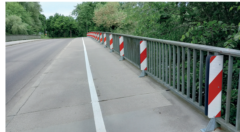
Weithin sichtbar: die Leitbaken, die übrigens keine Gefahr für Radler darstellen, da sie sich auf der Gehwegseite befinden (Bild rechts)
